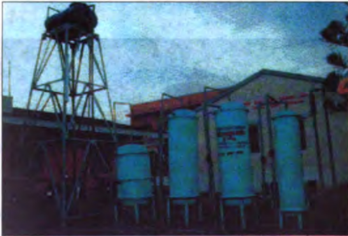
Hệ thống lọc nước sinh hoạt
