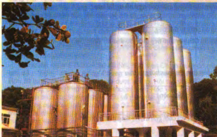
Hệ thống thiết bị lên men
