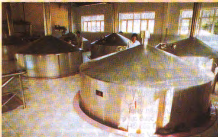
Hệ thống thiết bị nấu bia
