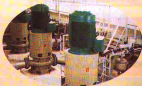
Nhà máy nước Mai Dịch công suất 60 000 m³ / ngày đêm
